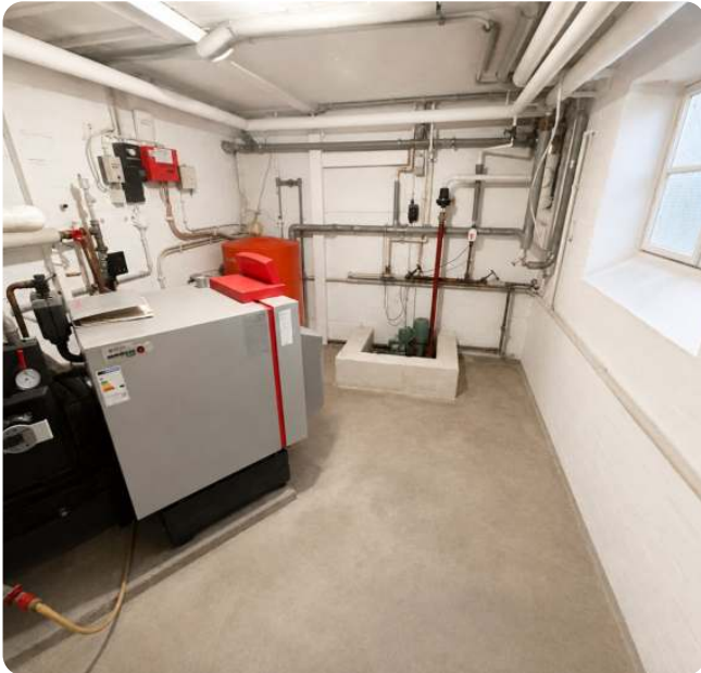
Heizkeller mit der regelmäßig gewarteten Heizungsanlage.
