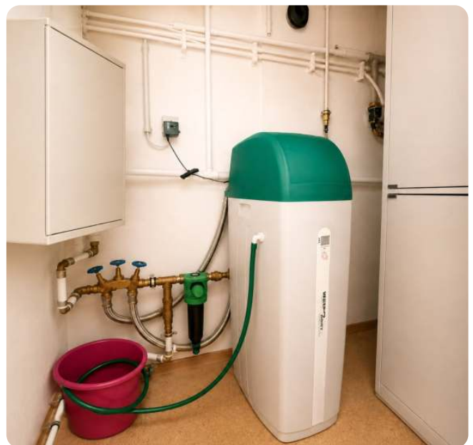
Hausanschlussraum mit Wasserenthärtungsanlage.
